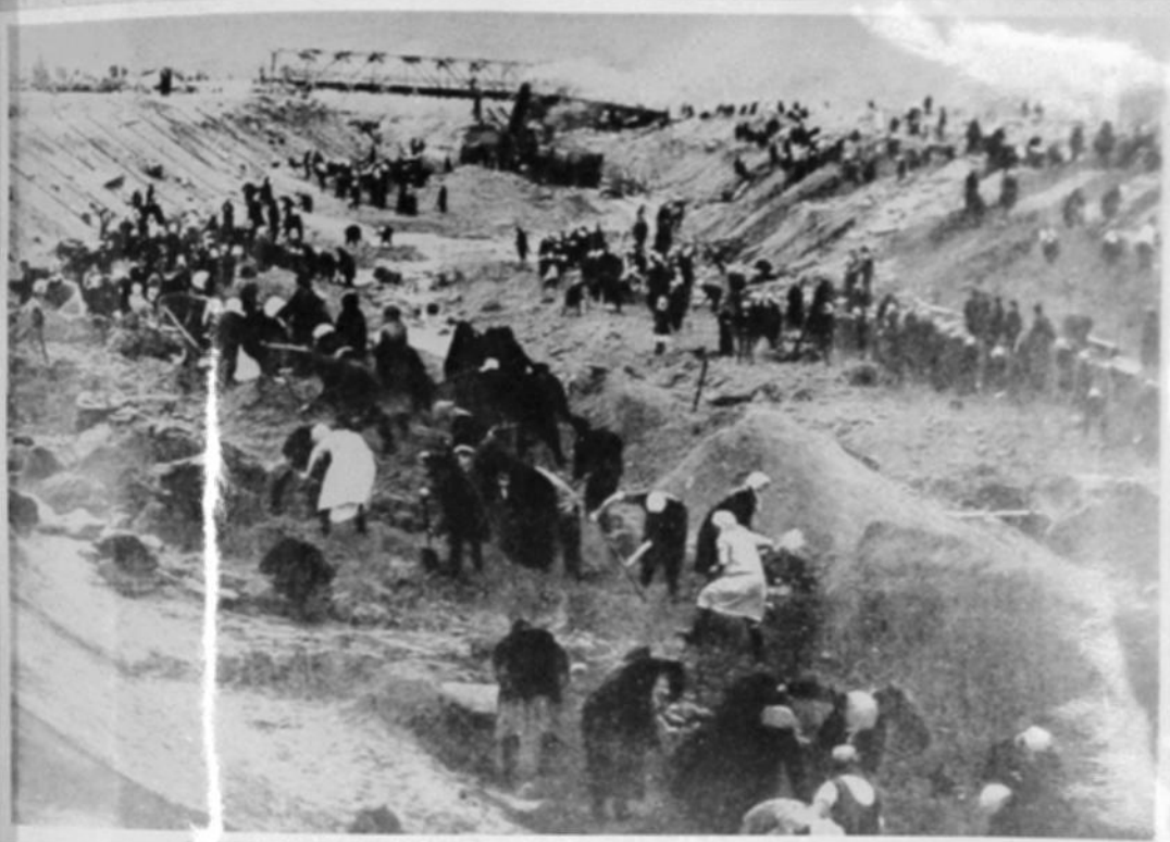
В организованном штурме по завершению земляных работ на деривационном канале участвовало 4800 человек.
