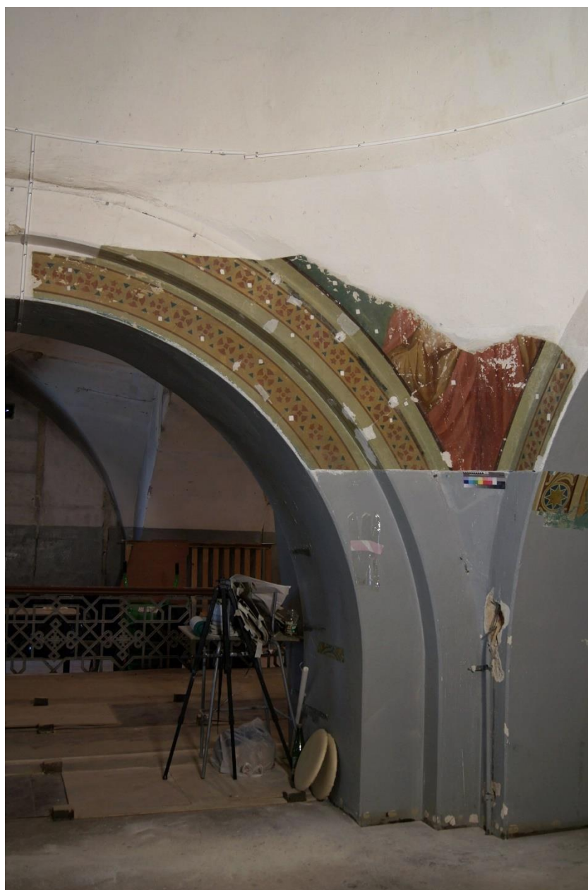
2.7 Общий вид северо-западного малого паруса с арками в процессе реставрации. В процессе удаления малярной побелки с поверхности живописного слоя. Прямое освещение
