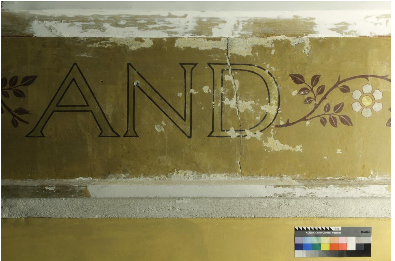
2.31 Фрагмент №4 в процессе реставрации. До начала укрепления шелушений и отставаний красочного слоя. Боковое освещение
