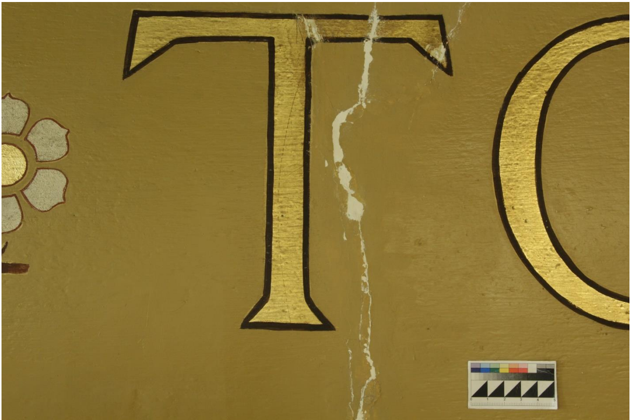
2.91 Фрагмент №12 в процессе реставрации. Трещины проинъектированы, подведён реставрационный грунт. Удалены загрязнения. Прямое освещение
