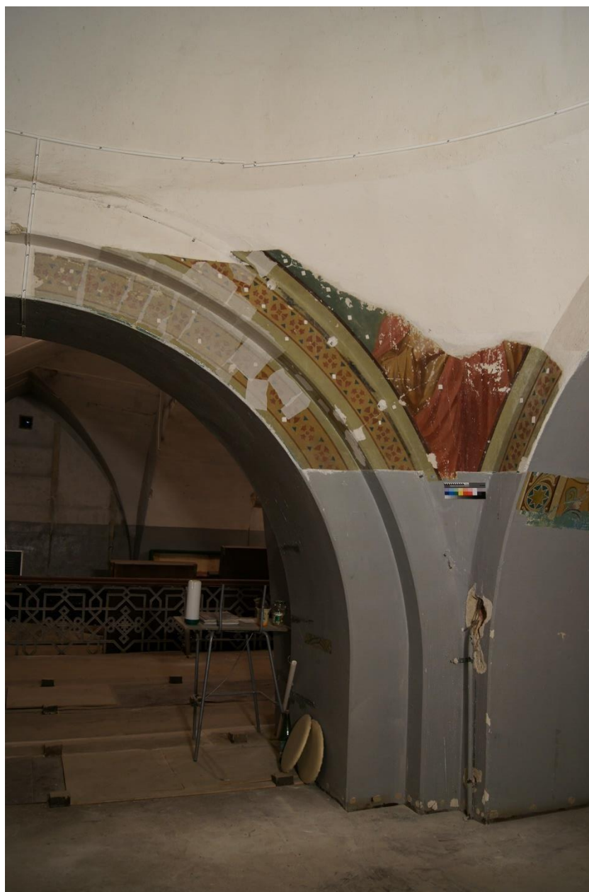
2.8 Общий вид северо-западного малого паруса с арками в процессе реставрации. Установлены заклейки из микалентной бумаги. В процессе укрепления отставаний красочного слоя в верхней части арок. Прямое освещение
