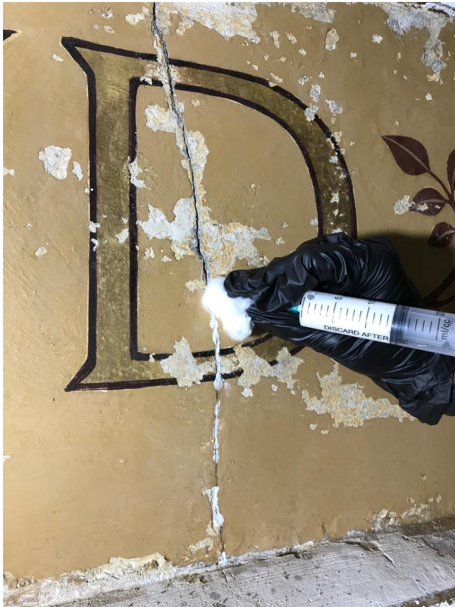
2.63 Фрагмент №7 в процессе реставрации. В процессе инъектирования трещины известковым раствором. Прямое освещение
