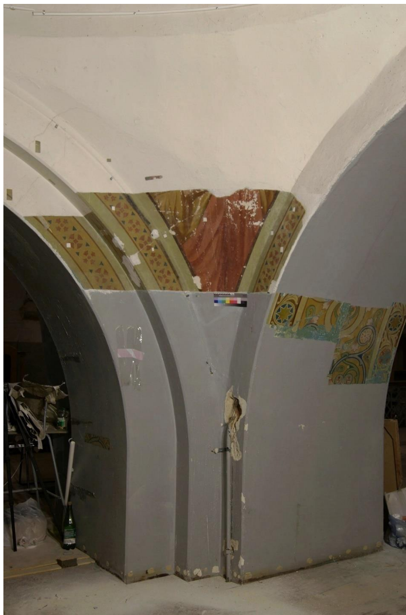
2.5 Общий вид северо-западного малого паруса с арками в процессе реставрации. В процессе удаления малярной побелки с поверхности живописного слоя. Прямое освещение
