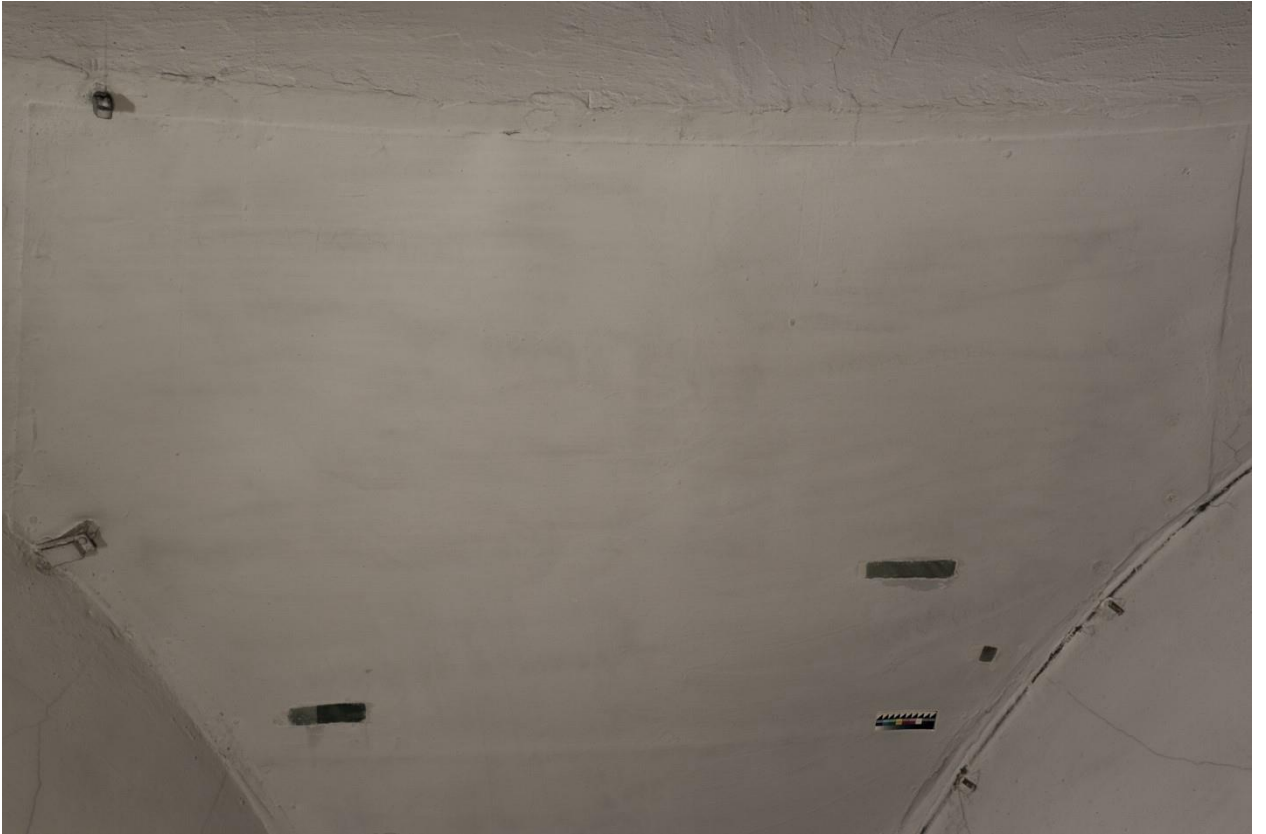
2.5 Фрагмент №1 реставрируемого участка северного паруса. Прямое освещение. До реставрации.
