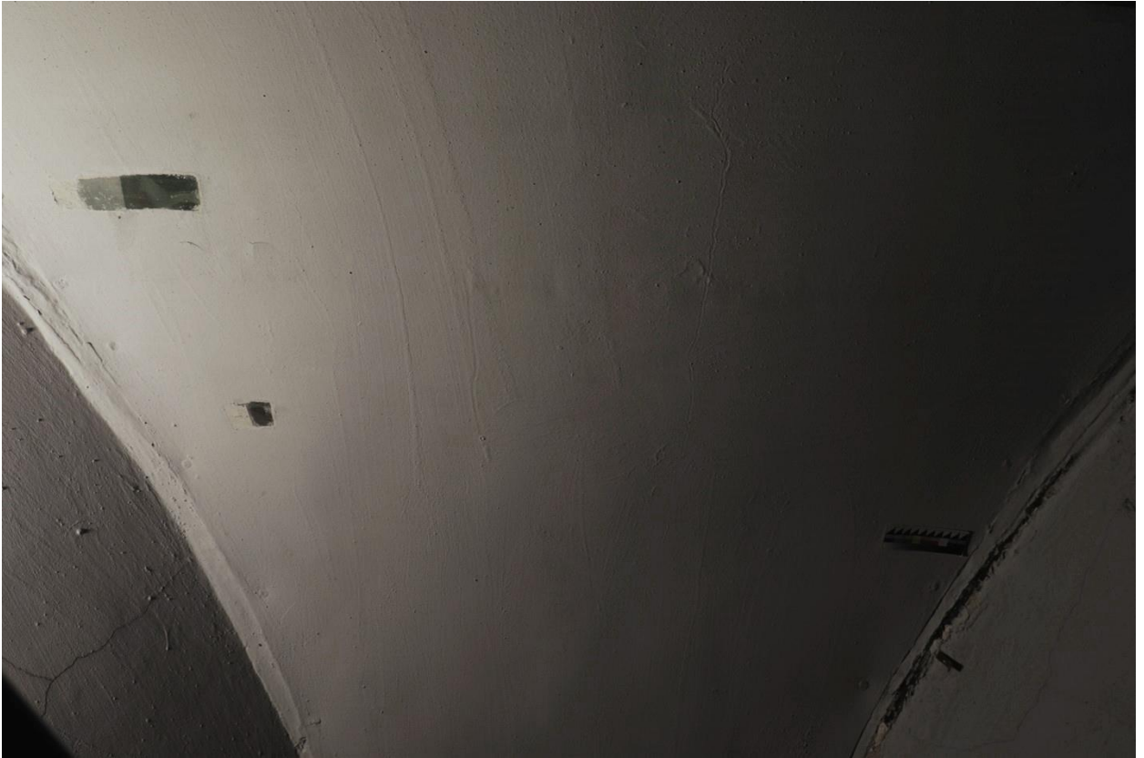
2.8 Фрагмент №3 реставрируемого участка северного паруса. Боковое освещение. До реставрации. Неравномерный слой побелки с вертикальными следами от кисти.
