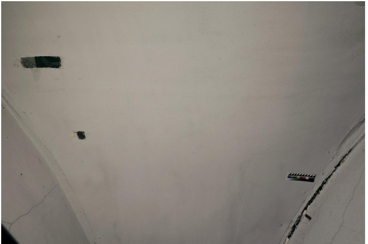
2.7 Фрагмент №3 реставрируемого участка северного паруса. Прямое освещение. До реставрации.
