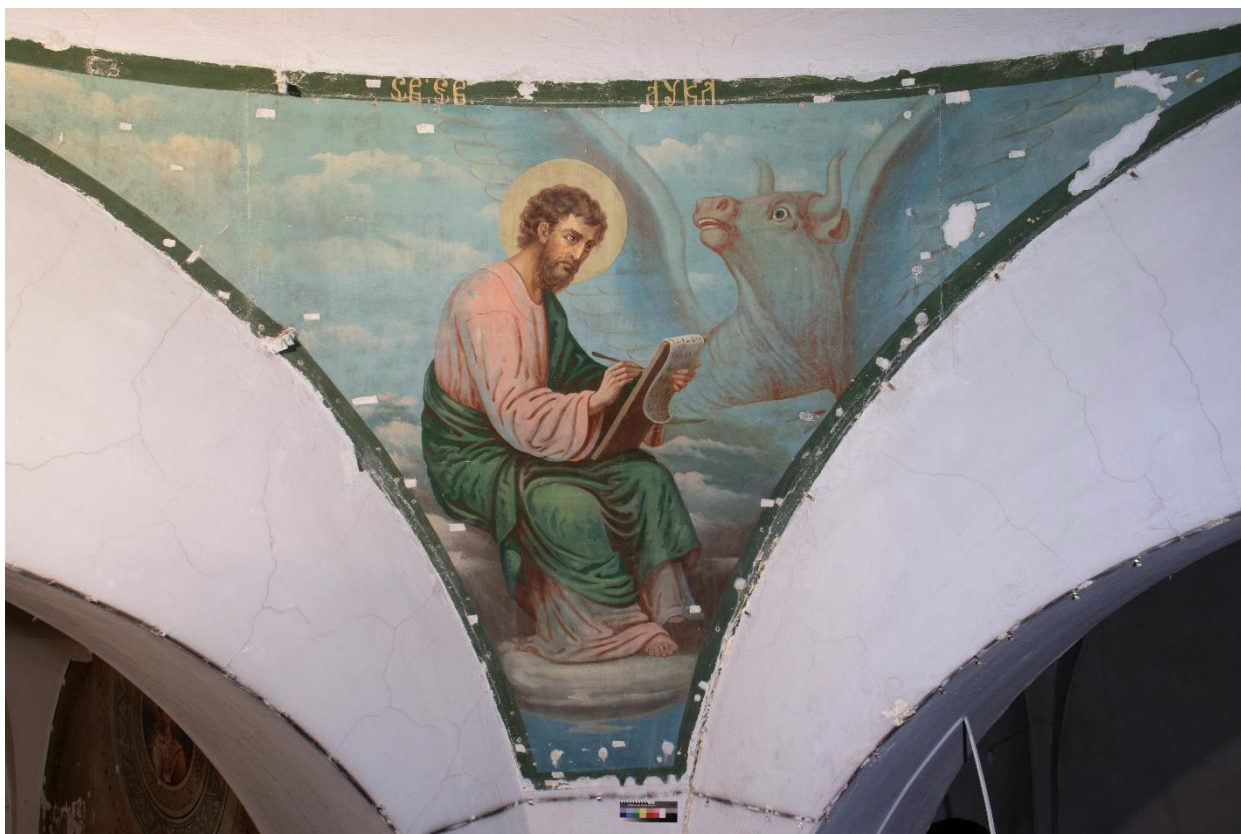
2.25 Общий вид северного паруса. Прямое освещение. В процессе реставрации. После удаления малярных закрасок с поверхности живописи оставлены контрольные участки малярной побелки.
