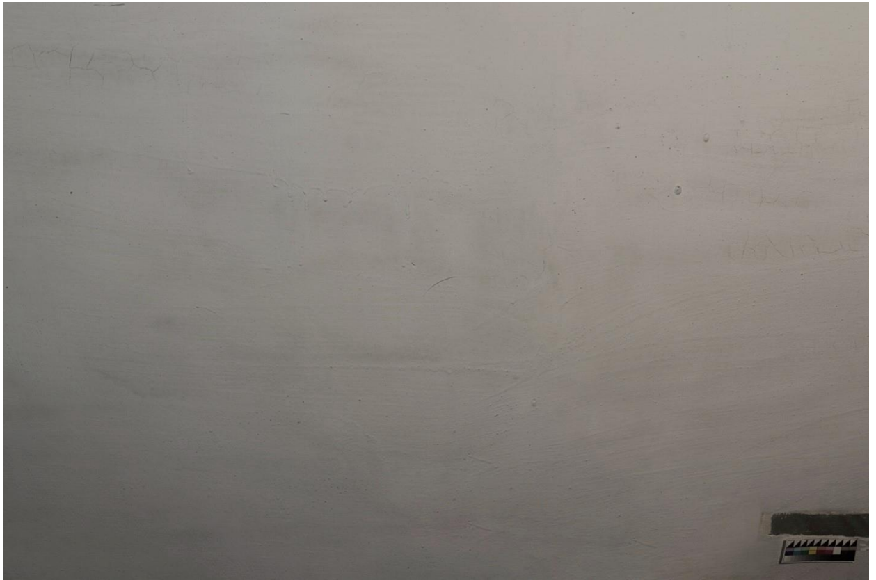
2.9 Фрагмент №4 реставрируемого участка северного паруса. Прямое освещение. До реставрации.
