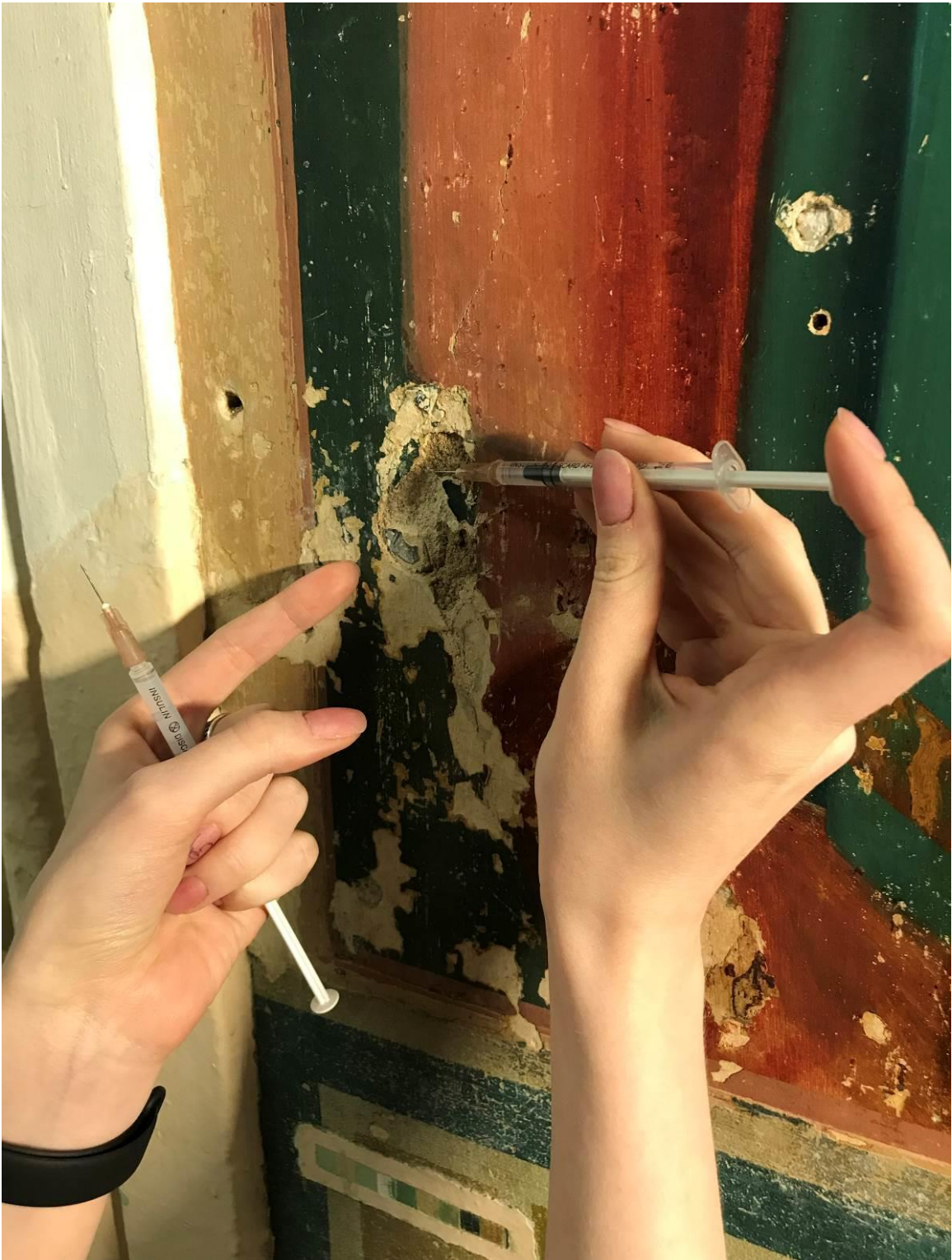
Рис. 3.3.3. В процессе обработки места деструкции штукатурного слоя этиловым спиртом.
