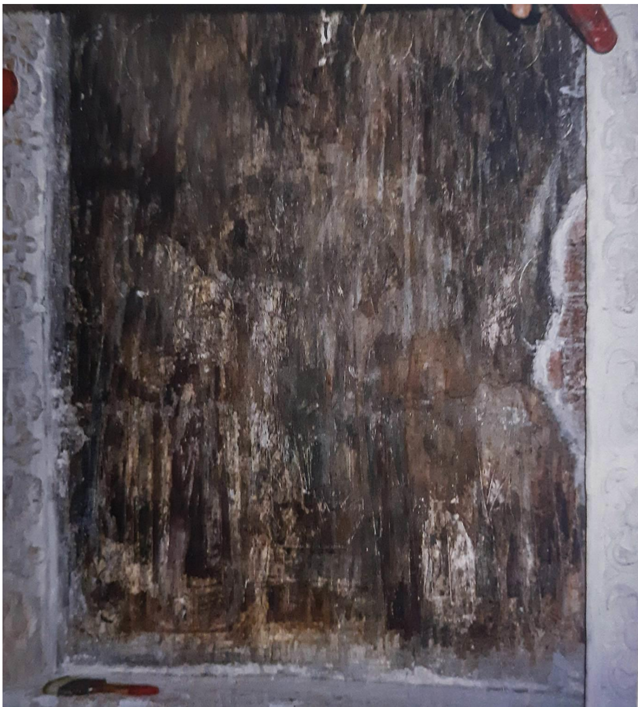
Рис. 1.1.15. Росписи XVI века над западным порталом Троицкого собора в Александрове, скрытые плотным слоем поверхностных загрязнений.
