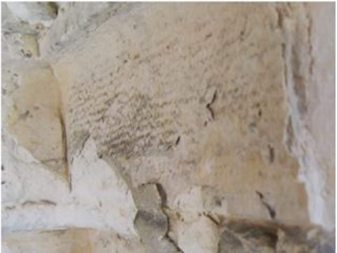
Рис.2.3.8. Типичные разрушения Пьетра д'Анжера. Отшелушивание и отслоение наружных слоев.
