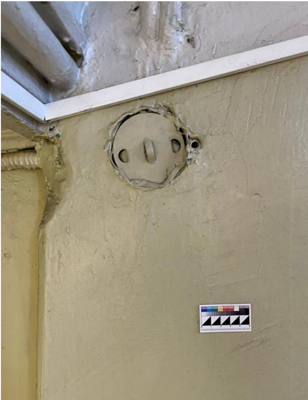
2.4 Фрагмент арки с распределительной коробкой. Прямое освещение
