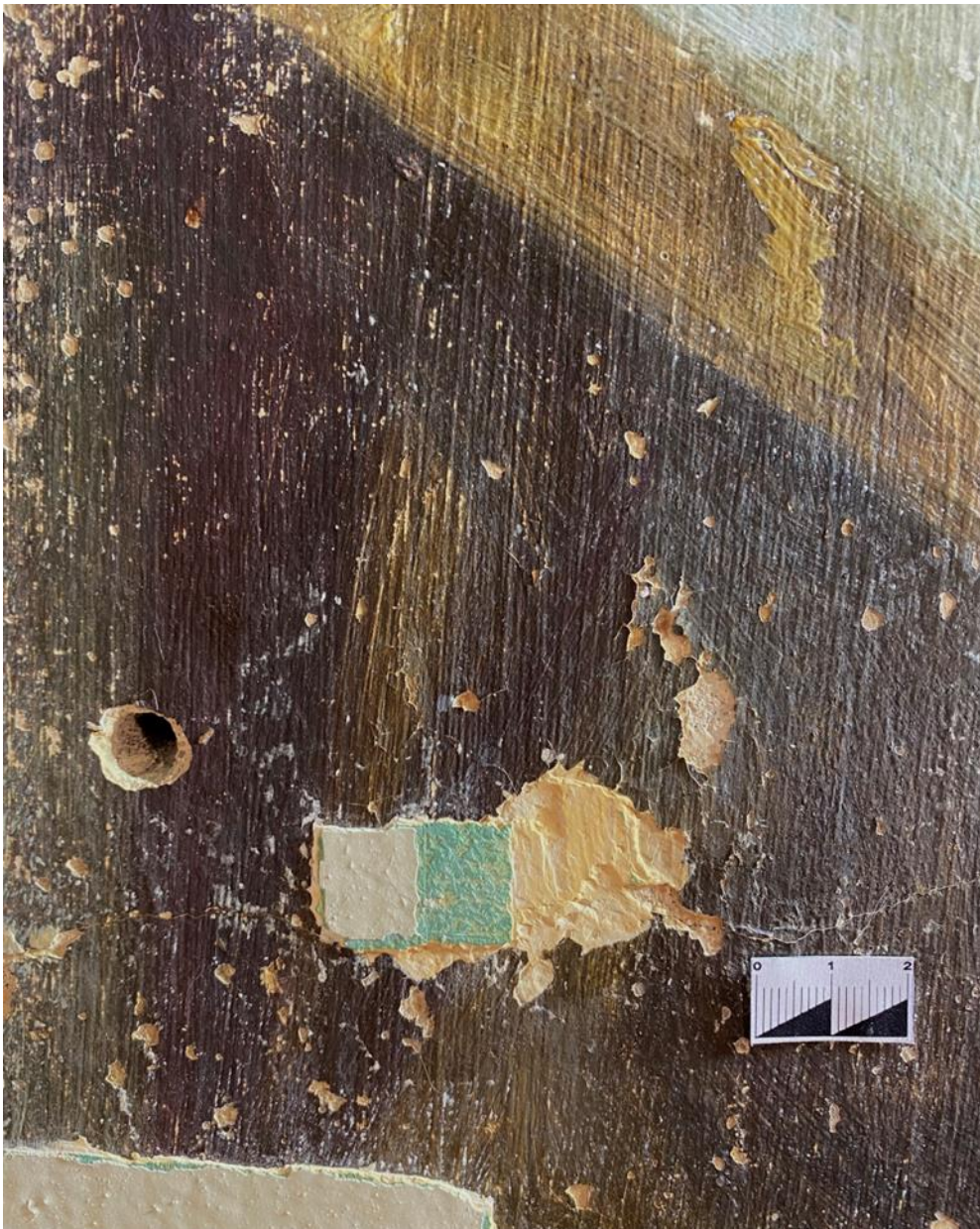
3.3 Фрагмент верхней части арочного проема в процессе реставрации до укрепления отставаний красочного слоя. Боковое освещение.
