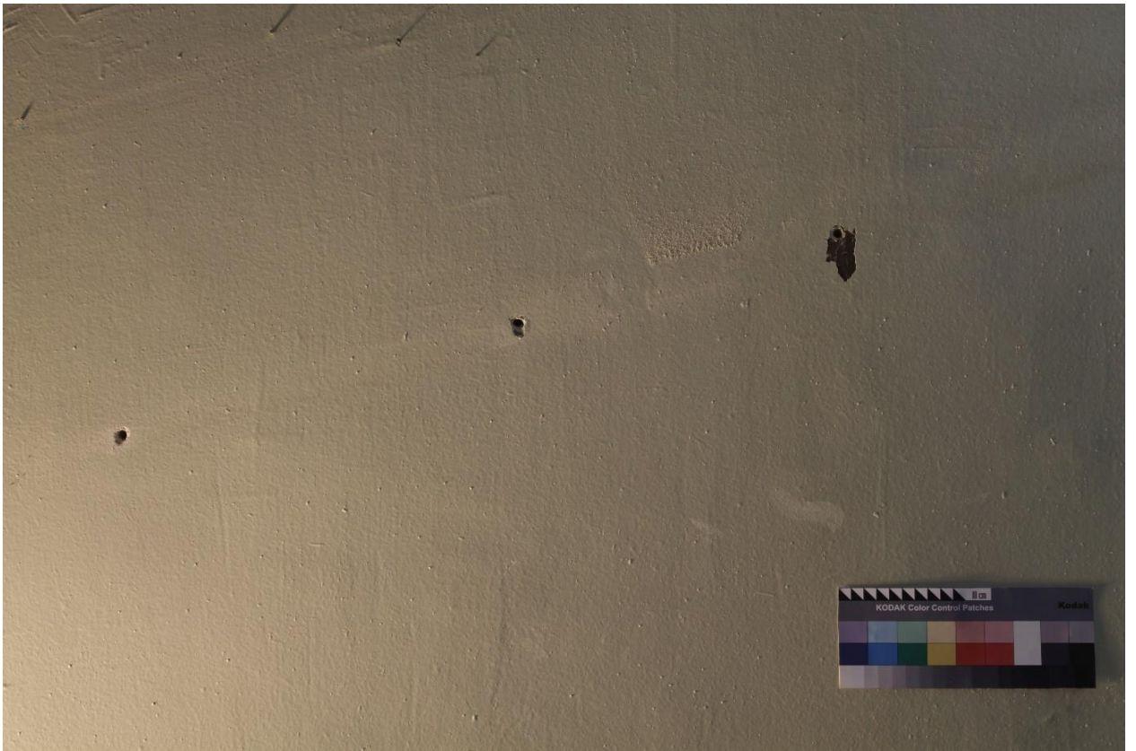
2.6 Фрагмент арки с утратами до основы в виде отверстий. Боковое освещение
