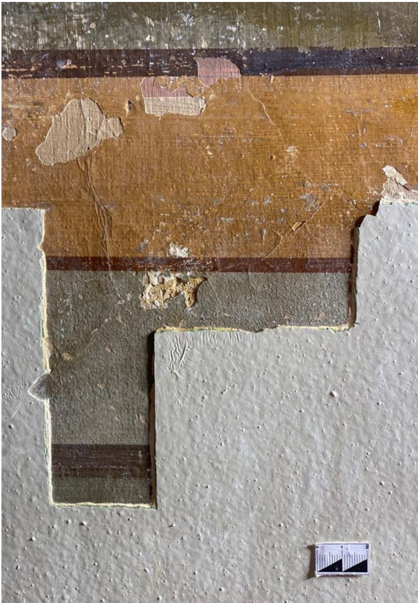
3.6 Фрагмент верхней части арочного проема в процессе реставрации после укрепления отставаний красочного слоя. Боковое освещение.
