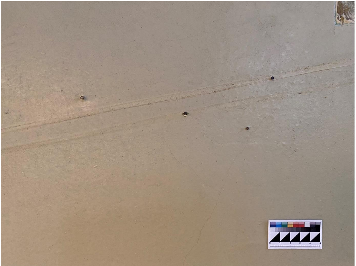
2.5 Фрагмент арки с утратами до основы в виде отверстий. Прямое освещение
