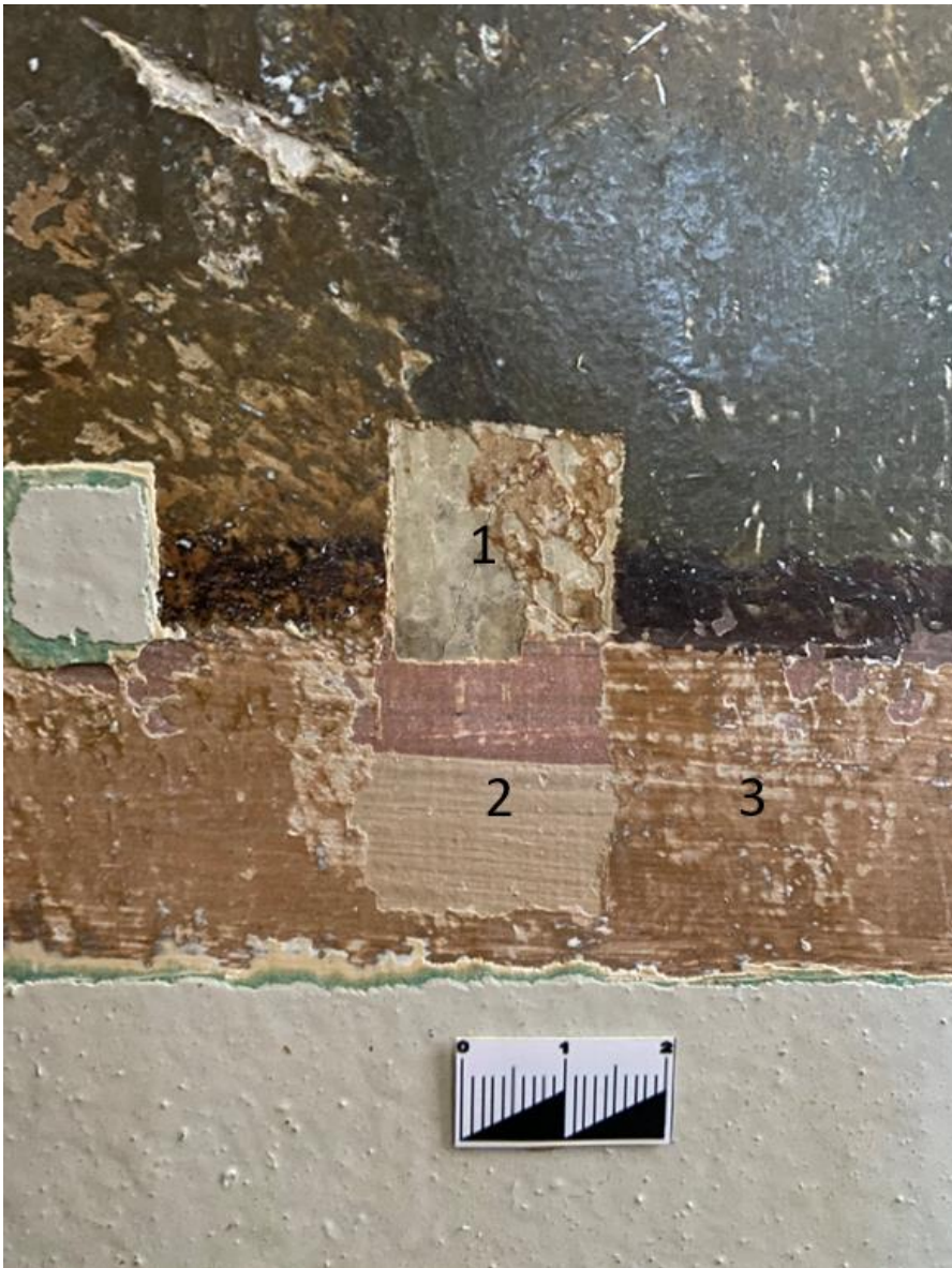
1.16 Исследование авторского красочного слоя и позднего живописного поновления. Пробная расчистка на изображении филенки. Прямое освещение
