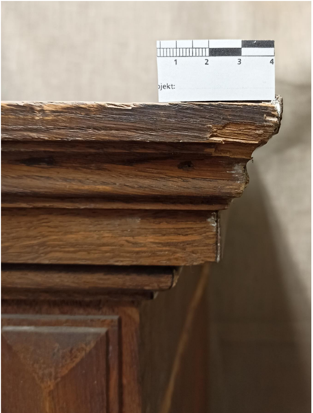
Фото №7: Сколы и выбоины на поверхности карниза (правый угол).
