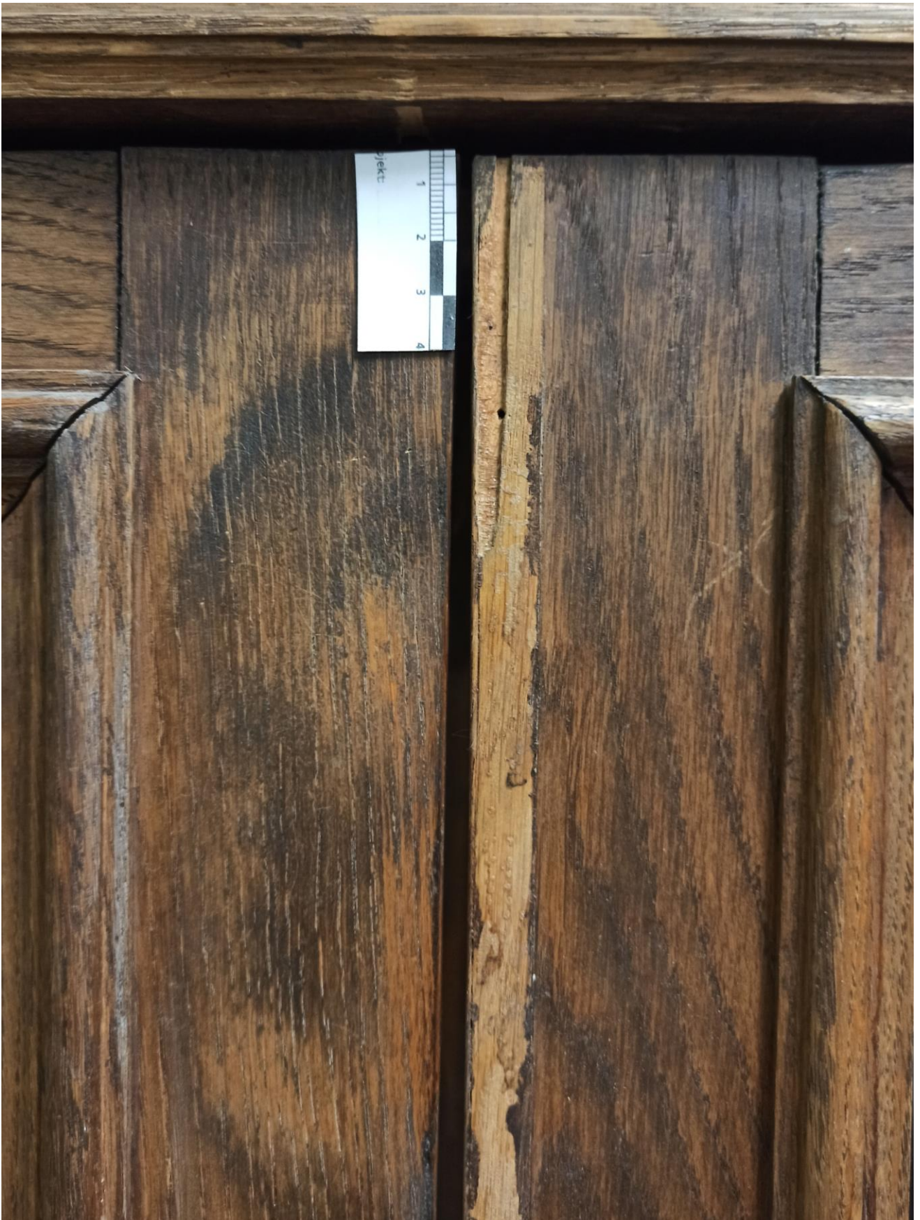
Фото №15: Утрата нащельника правой дверцы шкафа.
