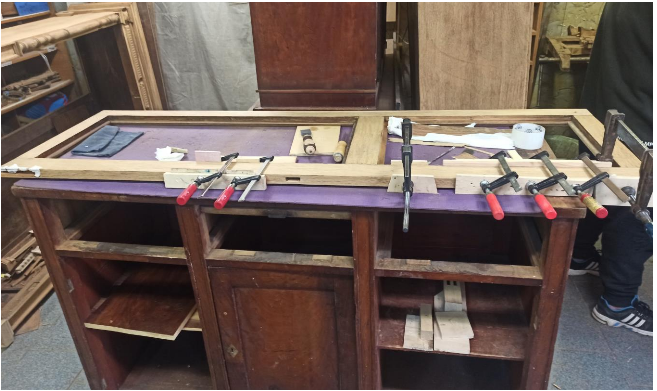
Фото №56: Процесс проклейки фанеровки в местах отхода от основы кромки левой дверцы.
