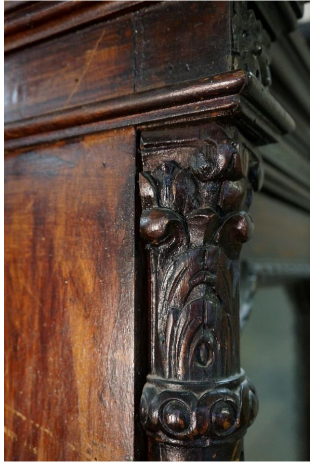
Фото №13. Утрата массива на капители колонны.
