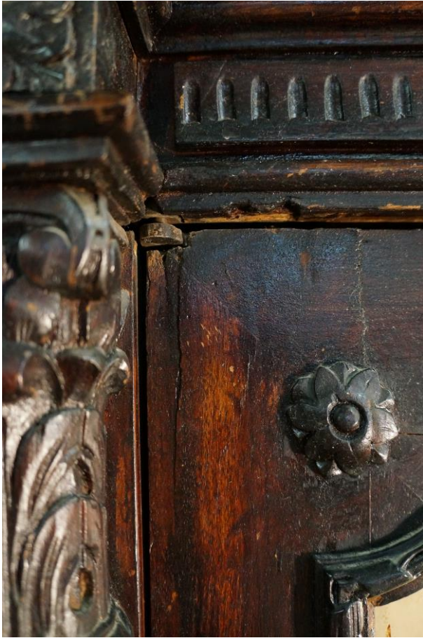
Фото №12. Повреждения левой дверцы и профиля фриза в области крепления пятниковой петли.
