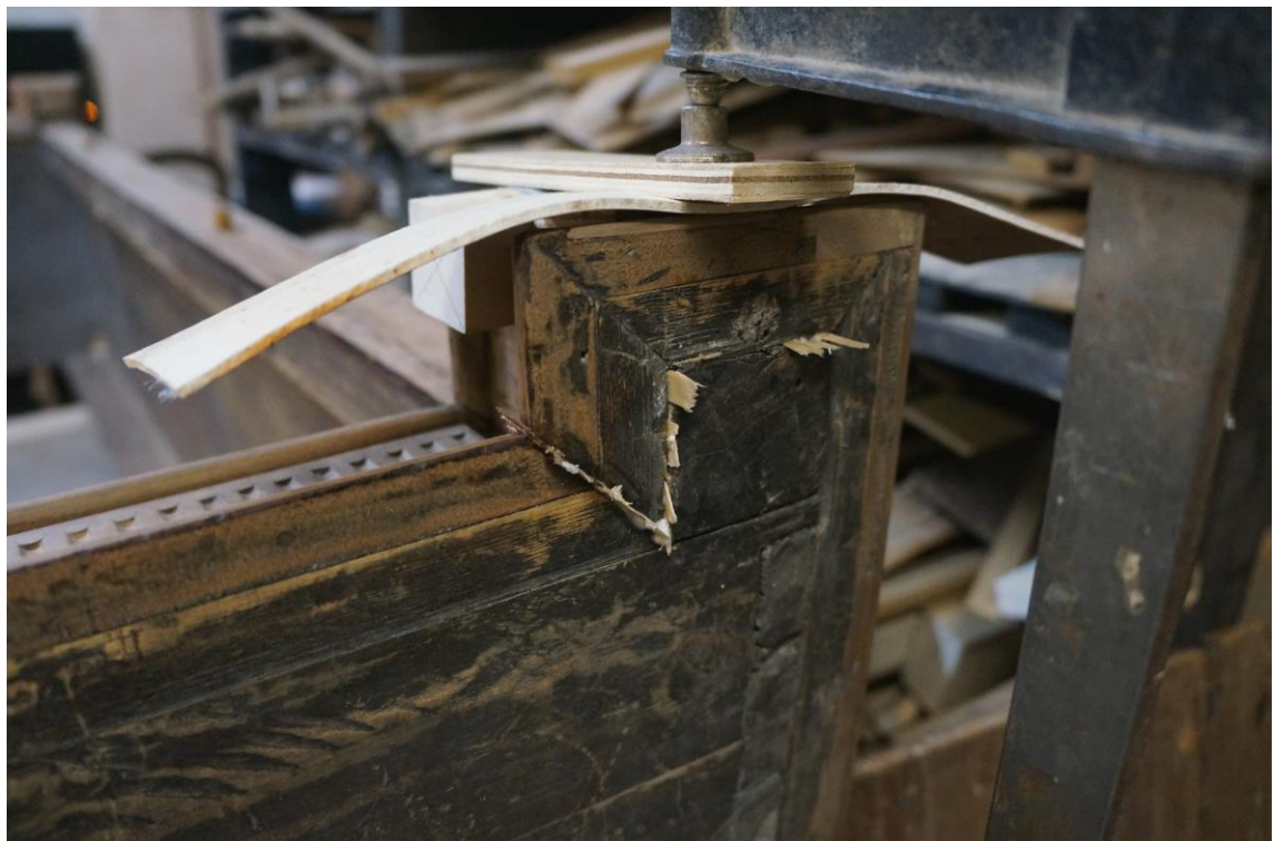
Фото №60. Заревивание трещин в области крепления раскреповки карниза.
