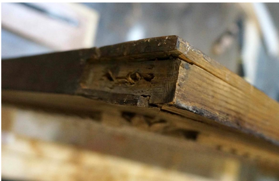
Фото №52. Трещины в области крепления верхней пятниковой петли на правой дверце.
