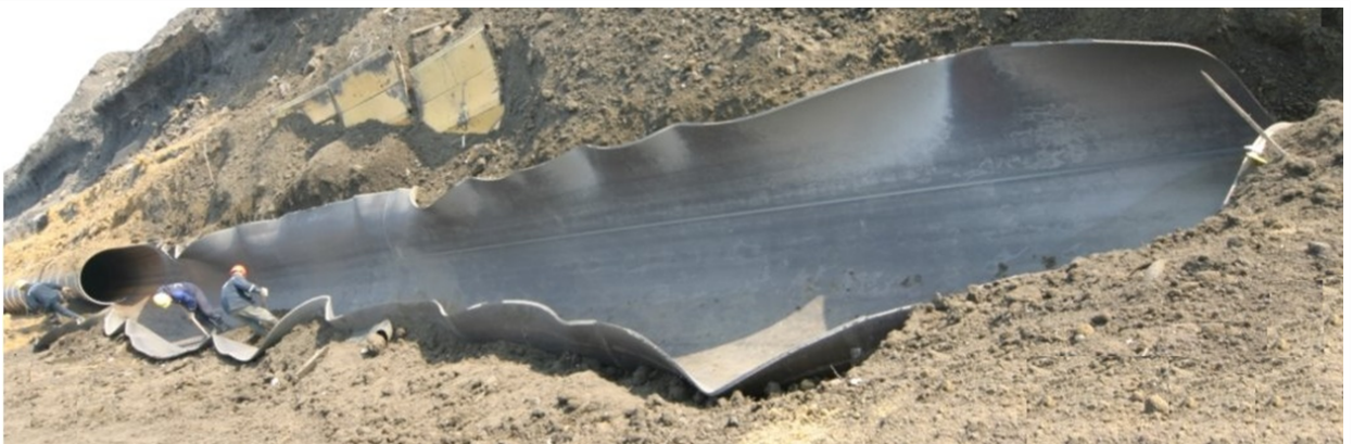
Рис. 3: Разрушение газопровода, Газпром, Россия, 2016
