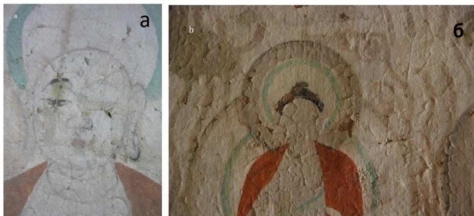
Рис. 37 Шелушения. а) шелушения на центральной колонне в 44-й пещере. б) шелушение после использования раствора желатина.
