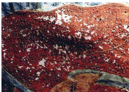
Рис. 22 Шелушение красочного слоя в пещере Могао № 217.
