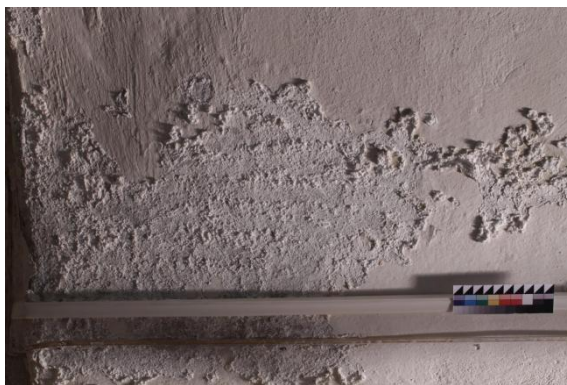
Рис. 90 Боковое освещение. Фрагмент с выходом солей на поверхность.
