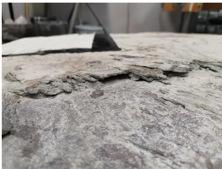
Илл.11. Расслоение каменной поверхности на плите.
