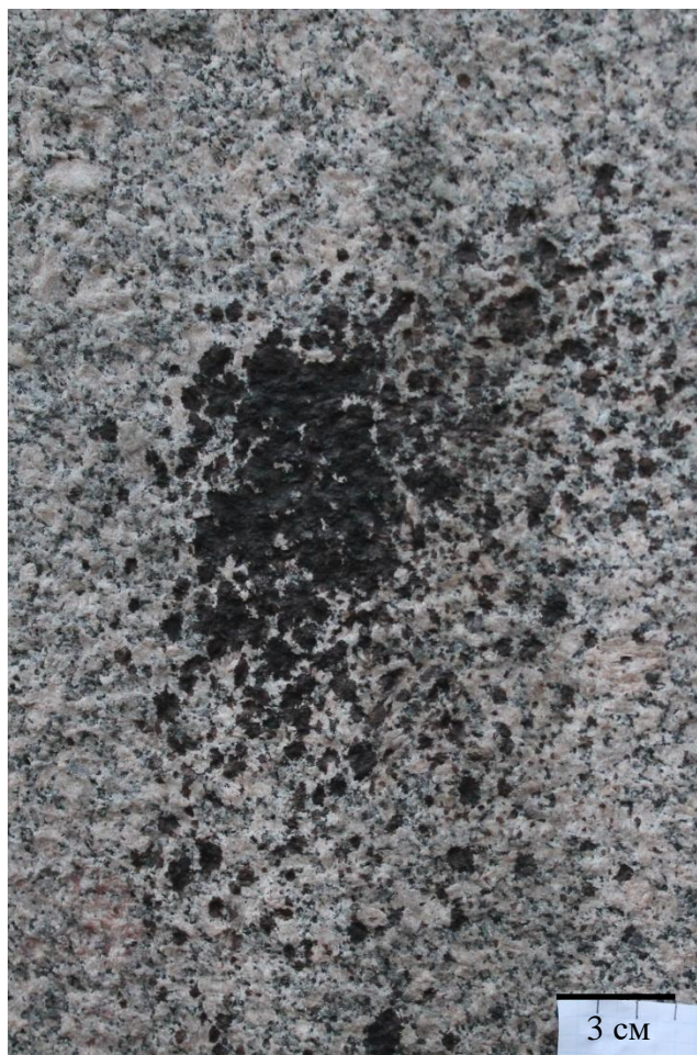
Рис. 19. Черная биопленка на поверхности гранита. Фото с набережной Обводного канала.
