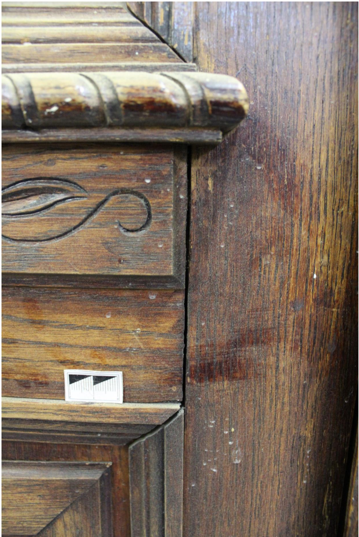
Фото №11. Трещины на дверных рамах
