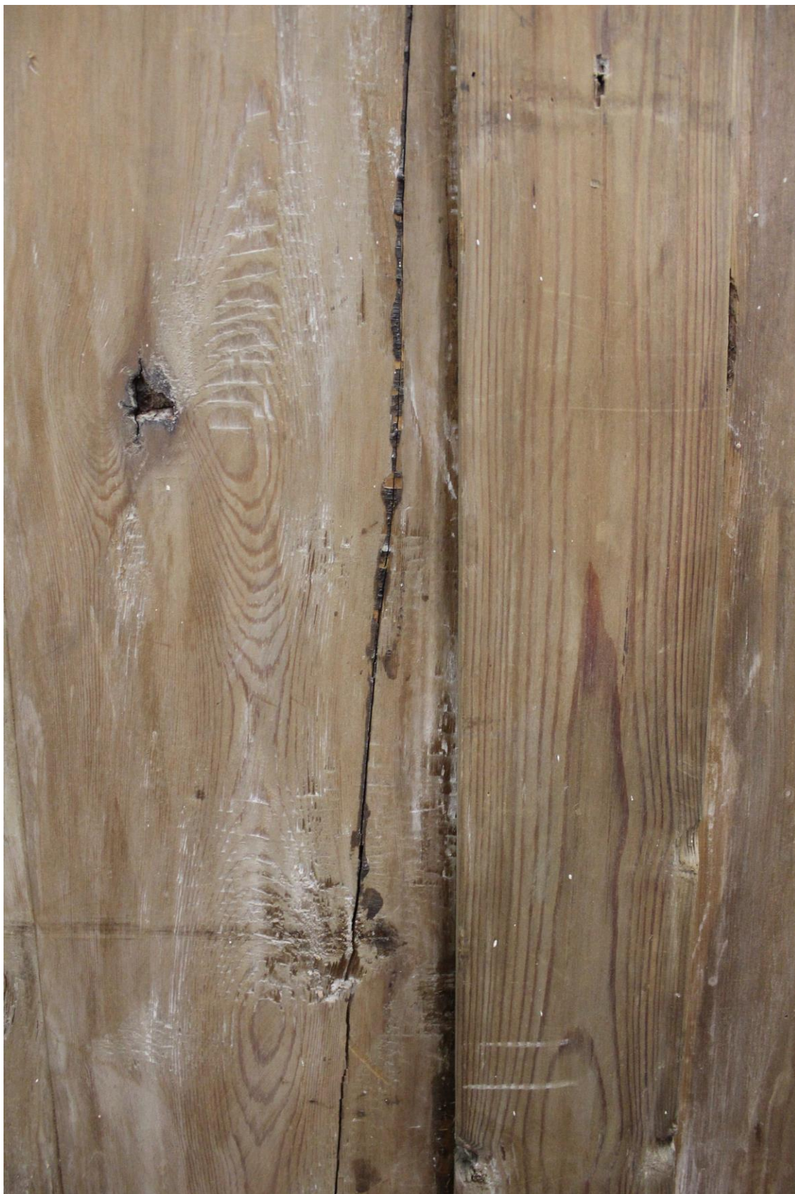
Фото №17. Трещины на заднем полке
