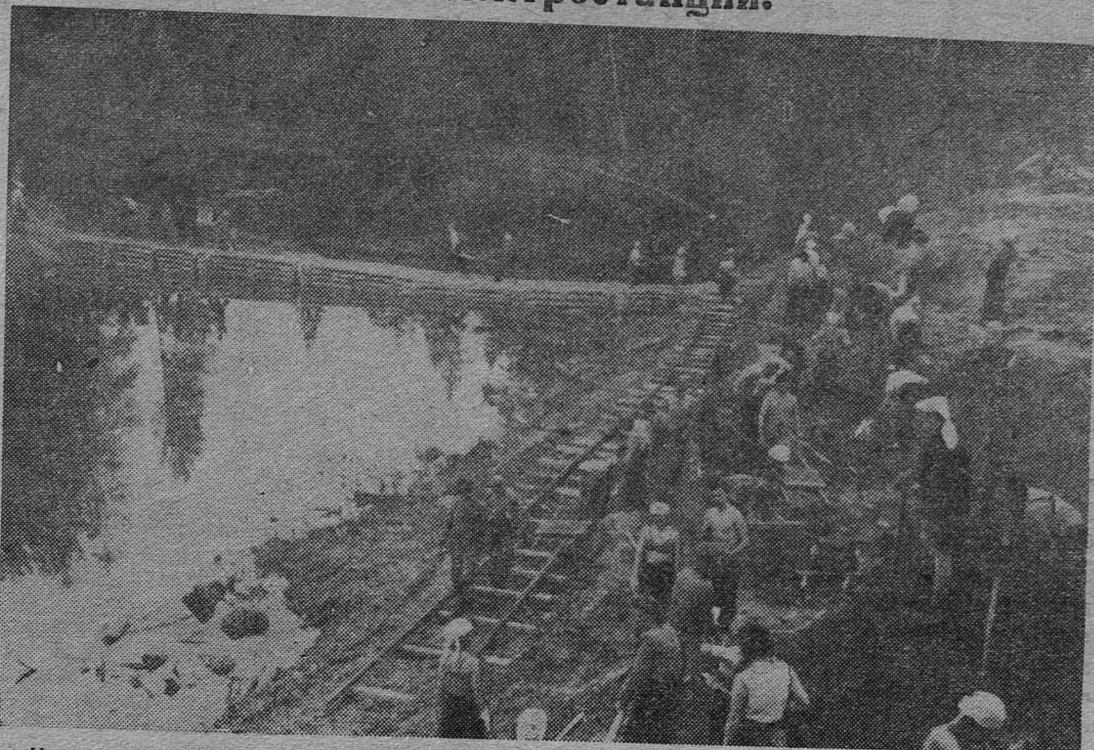
Никогда река Лиль не знала такого оживления. С раннего утра до позднего вечера успешно трудится студенческий коллектив на строительной площадке Медведковской электростанции. На снимке: бригада Л. Чекаловой на расчистке котлована для здания ГЭС. Фото Б. Слущкого
