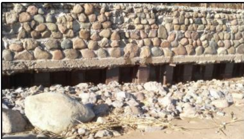
Рисунок 27. Подмытая каменная стенка. Зеленогорск. Фото автора
